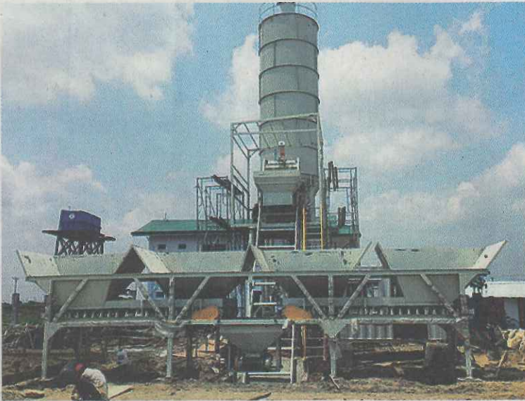
ヤンゴンで建設中のコンクリート工場 (会沢高圧コンクリート提供)
